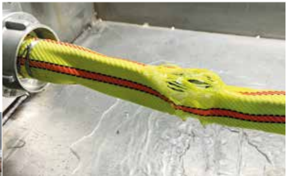
Ohne Abrieb geplatzter Feuerlöschschlauch
